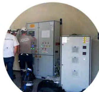
Blick in den Turmfuß mit Steuerungstechnik
