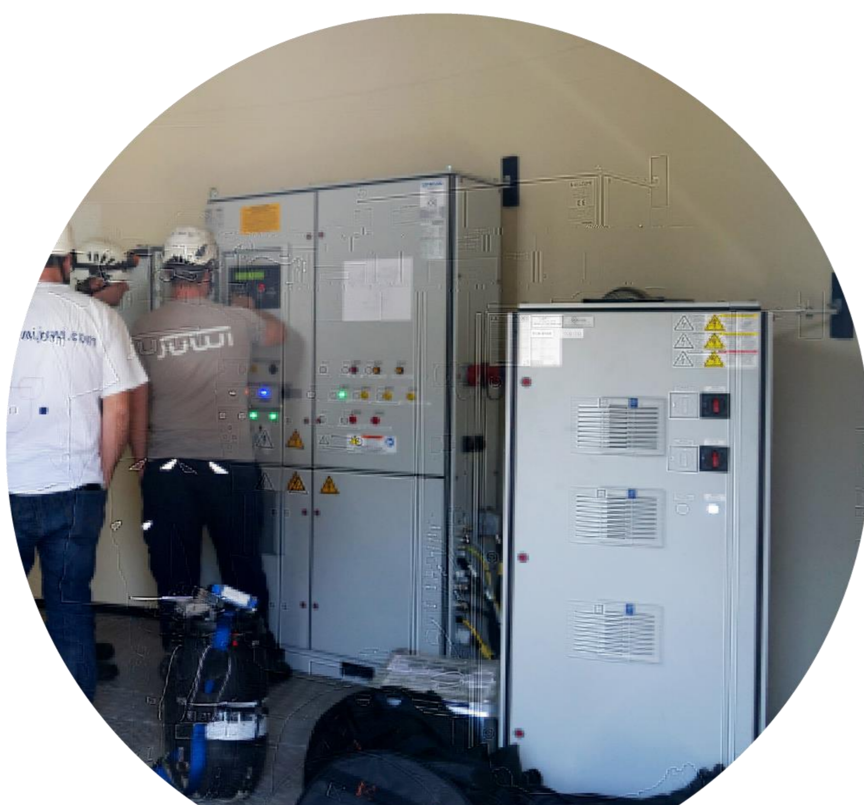
Blick in den Turmfuß mit Steuerungstechnik
