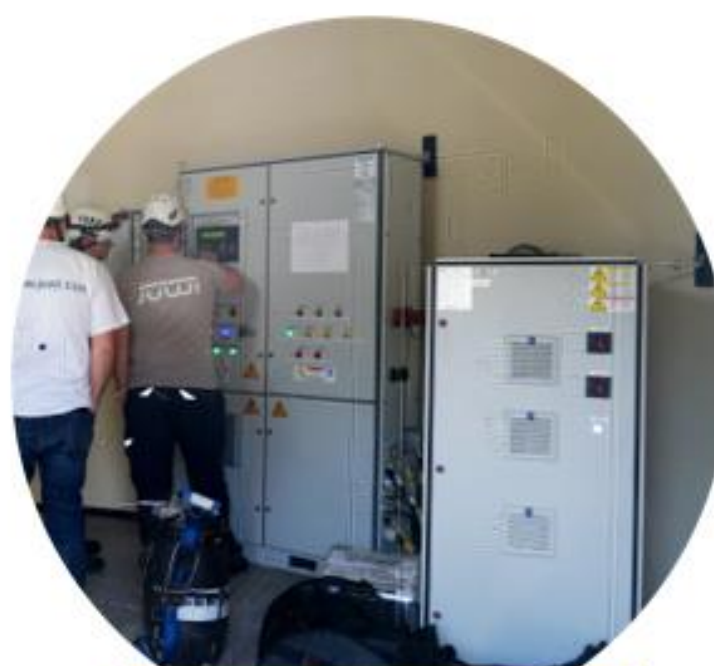
Blick in den Turmfuß mit Steuerungstechnik
